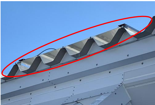
図1 建屋折板屋根上部 融雪パネル（兼）雪止め
