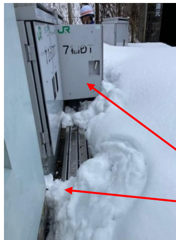
図4 降雪時の状態 電気器具箱をいつでも 開閉できる状態
