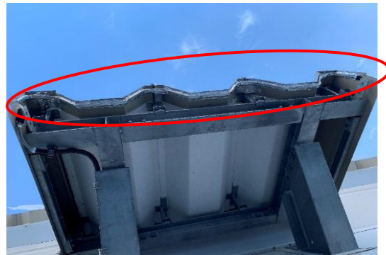
図2 軒先折板ツララ防止 ツララ防止ヒーターの設置
